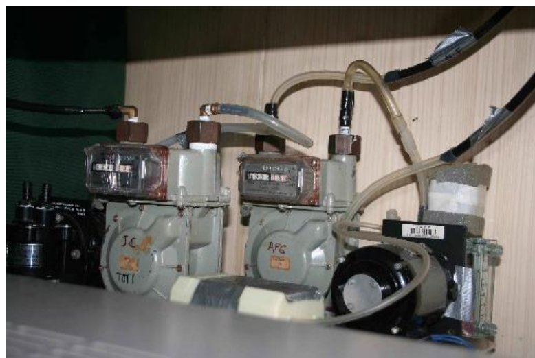
Figura 7. Bombas, sistemas integradores de vazão e medidor de fluxo instalado no Passadiço do NApOc Ary Rongel – Operantar XXVI.
