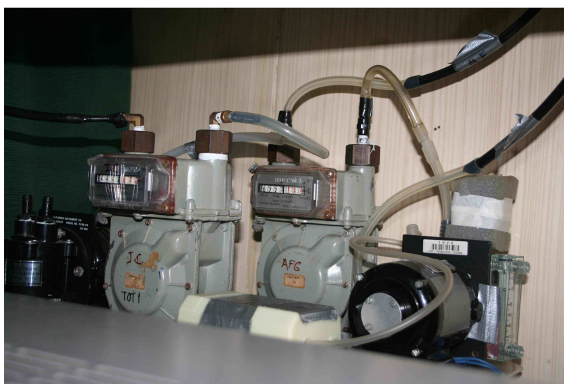
Figura 8. Bombas, sistemas integradores de vazão e medidor de fluxo instalado no Passadiço do NApOc Ary Rongel – Operantar XXVI.
